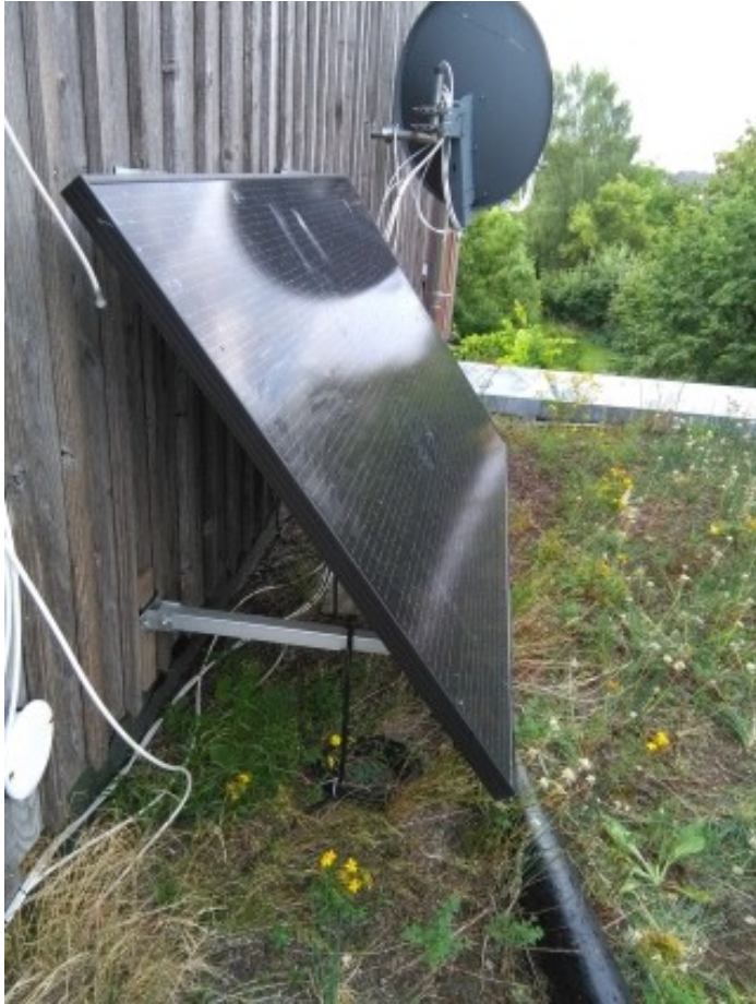
Modul - schräg an Hauswand befestigt
