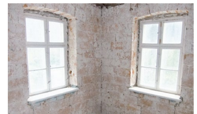
Abbildung 83 Fenster im Bestand mit Einfachverglasung
