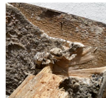
Abbildung 3 Pilzbefall unter Fußbodendielung
