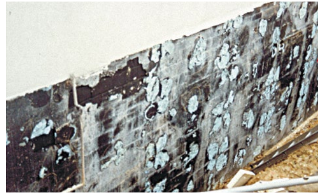
Abbildung 102 Perimeterdämmung war nicht vollflächig verklebt. Die Dämmwirkung wurde stark reduziert, da Wasser hinter die Dämmebene gelangen konnte
