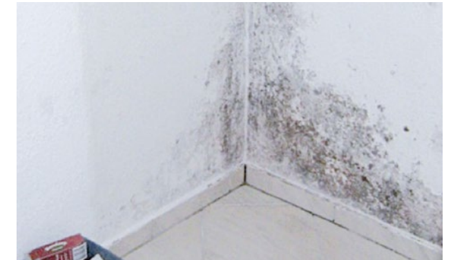
Abbildung 10 Schimmelenstehung in einer Rauminnen-ecke aufgrund unzureichender Oberflächentemperatur
