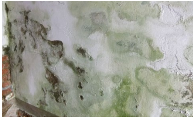
Abbildung 59 Extrem durchfeuchtetes Außenmauerwerk
