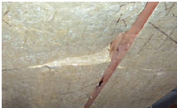
Abbildung 32 Zusammgedrückte Wärmedämmung zwischen den Sparren
